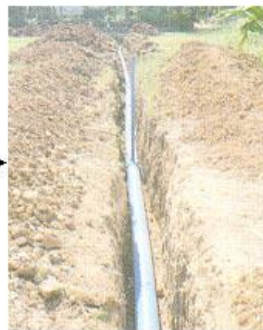
6. ท่อจ่ายน้ำ
